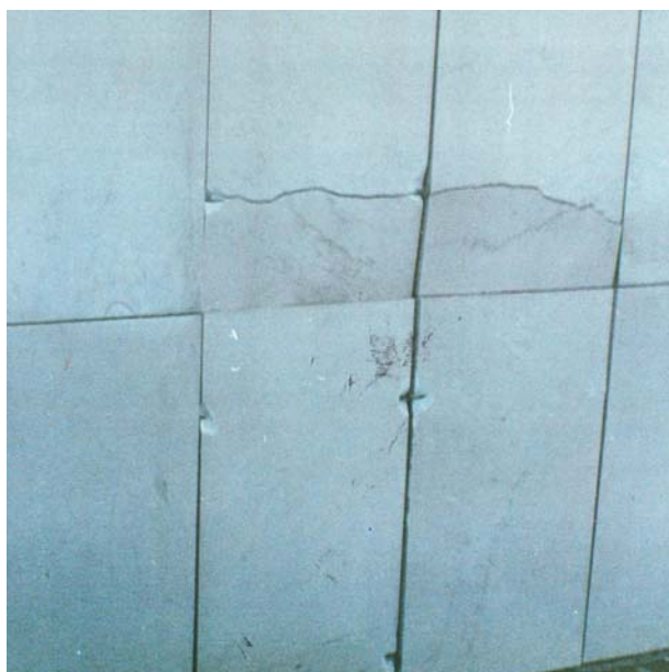
Slika 1. Karakteristična oštećenja kamenog opločenja
